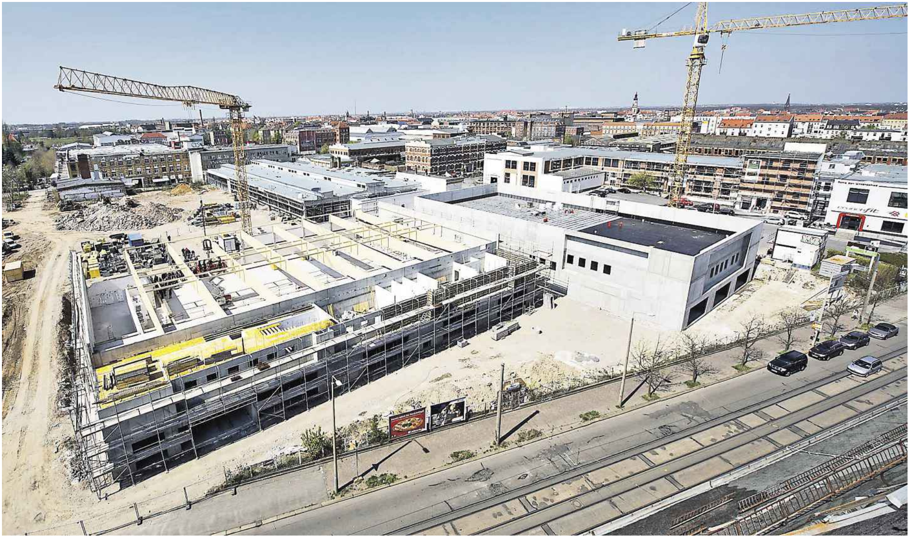
Der Rohbau des Fachmarktzentrums an der Zschocherschen Straße (unten) ist abgeschlossen. Neben dem Rewe-Markt (links) entsteht noch eine Zufahrtsstraße zu einem Parkplatz, der in der Mitte der drei riesigen Hallen angesiedelt wird. In den Neubau rechts zieht Penny ein. Dahinter wurde ein historisches Fabrikgebäude saniert. Foto: Steffen Spitzner
